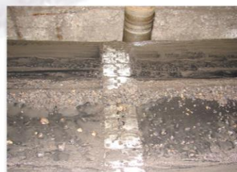
MS45 в угольной электростанции
