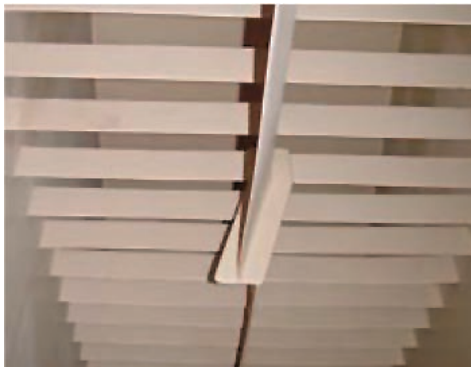
Отбойники в канале очищенного газа
